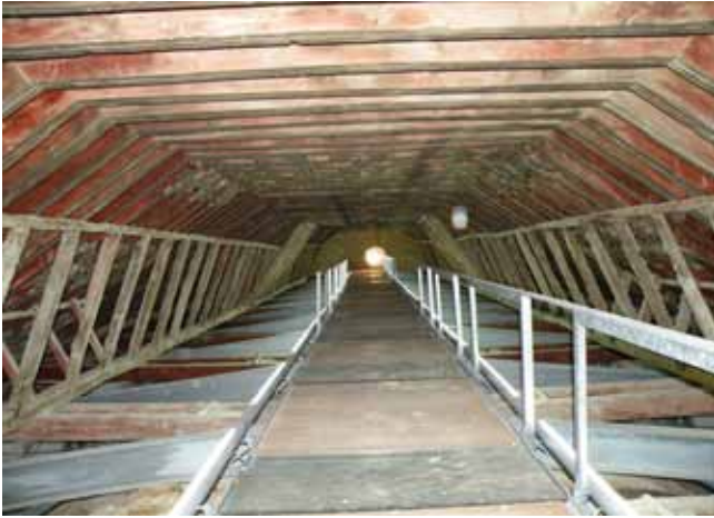
Iglesia de Santiago en Carmona (Sevilla) donde la bóveda cuelga de la estructura de par y nudillo. AITIM
