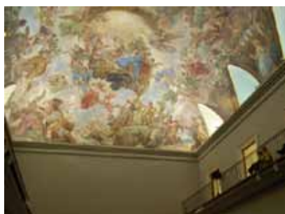
Casón del Buen Retiro. La bóveda pintada, vista desde el interior. AITIM
