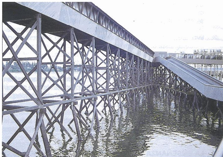
Estructura de madera en contacto con el agua. Embarcadero en el lago de Washington.
