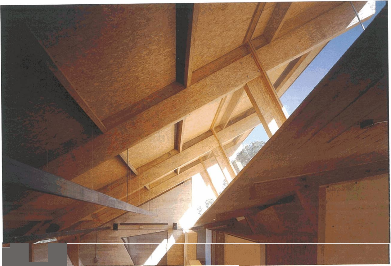
Techos de OSB sobre vigas de PSL Parallam. Aula de la Naturaleza en Valle de los Perales. Arquitecto Javier Bernalte. Foto Ángel Baltanás
