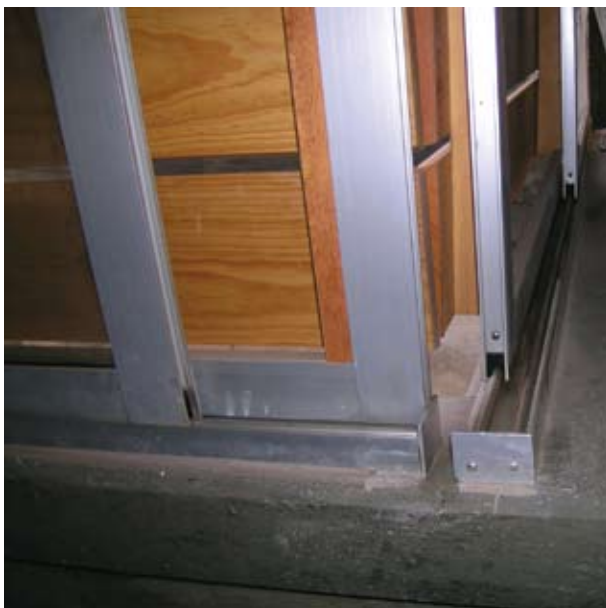
Encuentro de guías de la contraventana en esquina donde se aprecia el doble carril (contraventana y ventana)
