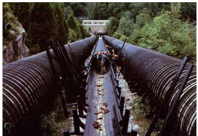
Tubería de desagüe de una presa realizada por la empresa Canbar (Ontario, Canadá)
