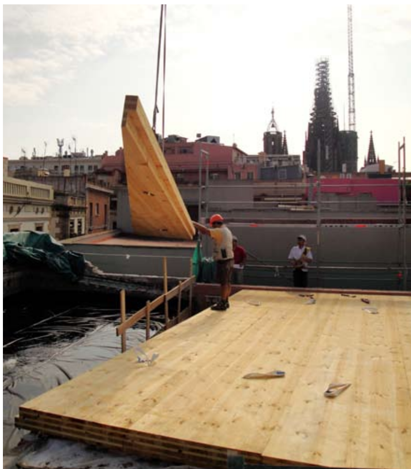
El proceso de montaje se inicia con la colocación, mediante grúa, forjado de cubierta. Foto: S. Bestraten
