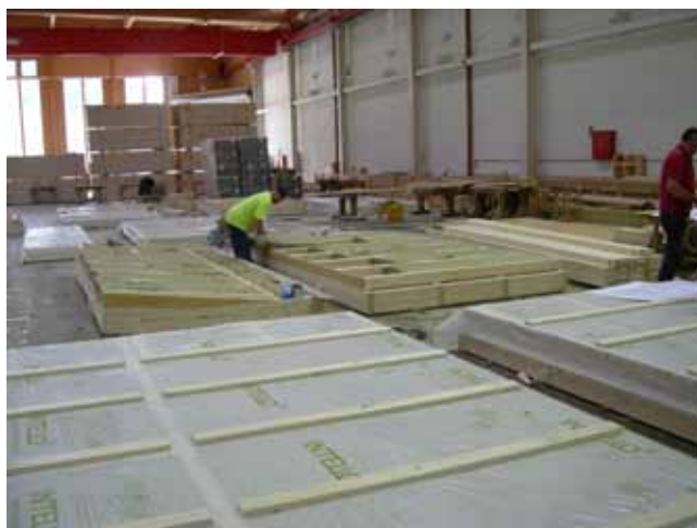
Fabricación de módulos de cubierta para un supermercado de la cadena Billa
