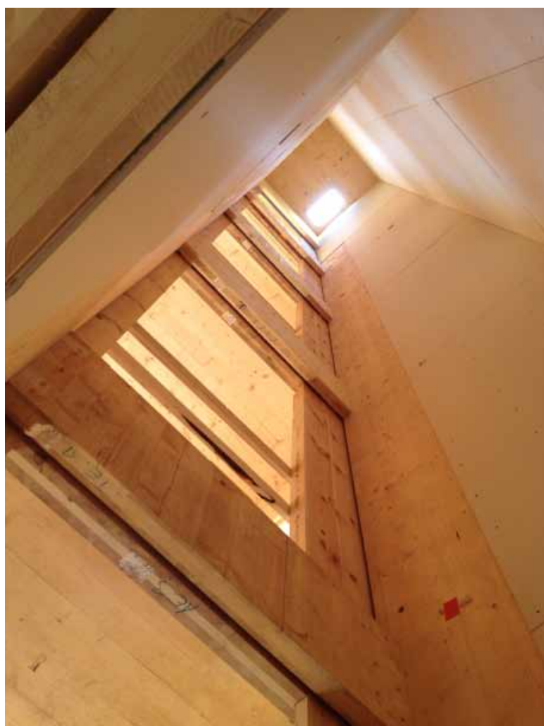
Cajón de ascensores
