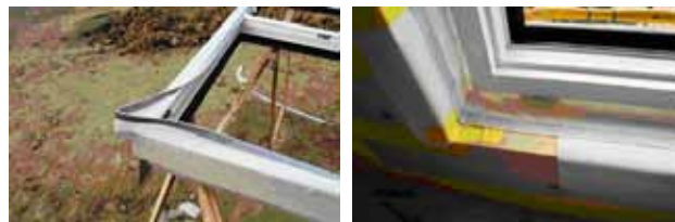
Colocación de membrana de estanqueidad entre marco y premarco. Detalle de colocación previa en marco
