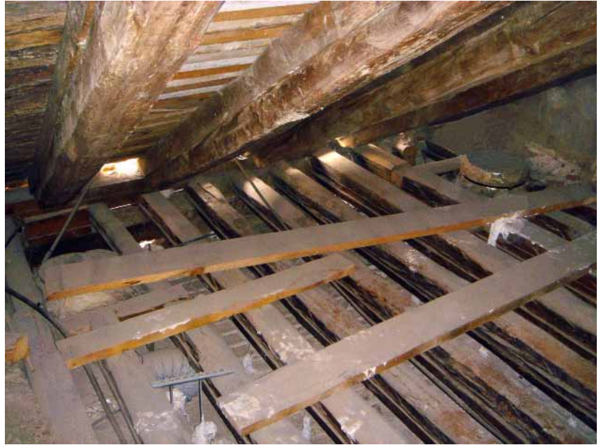
Estado inicial de los forjados de madera
