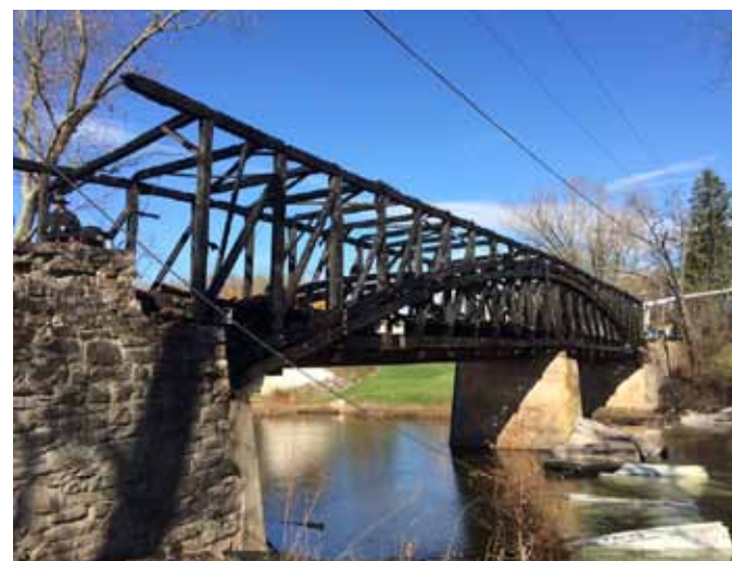
EN ESTE PUENTE DE MADERA, LA FORMACION DEL CARBON HA PERMITIDO SALVAR LA ESTRUCTURA, AL MENOS PARA MANTENER SU CAPACIDAD PORTANTE PROPIA
